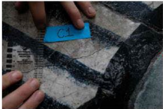
3 CRACK ID - C1
